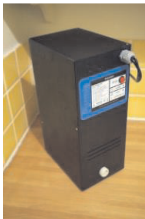
圖 8 側壁型細水霧設備加壓幫浦
